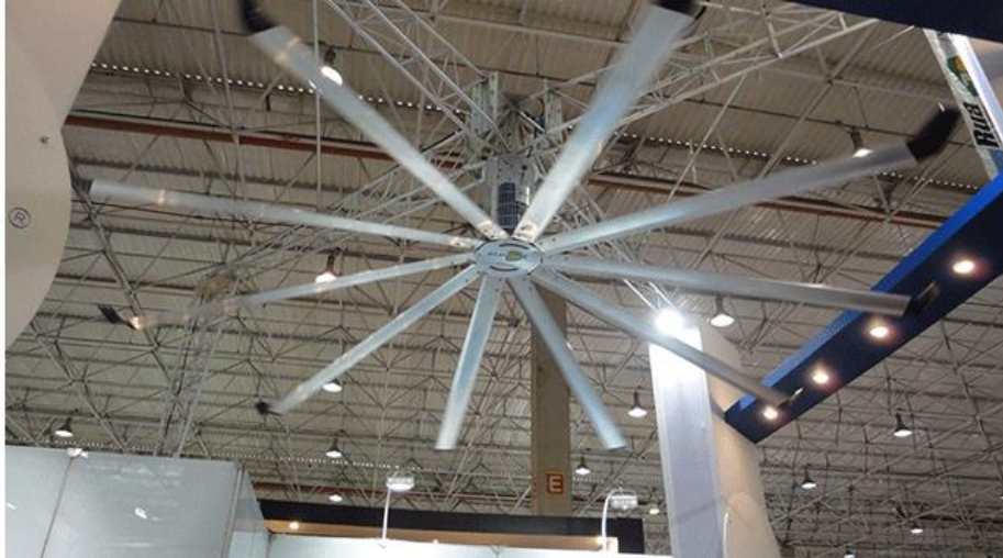
Figura 8: Ventilador HVLS em operação
